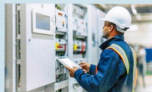
Elektrische Anlagen Ständige Überwachung
