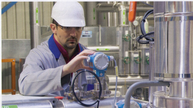
Steigende Kosten für die Produktion von Dampf sowie Vorgaben von Energiemanagementsystemen gemäß ISO 50001 erfordern eine systematische Erfassung der Energieströme. Bilder: Endress+Hauser
