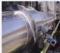
Die Messtechnikspezialisten ermöglichen eine rückführbare Überprüfung und Gesamtgenauigkeitsbewertung von Dampfmessstellen.
